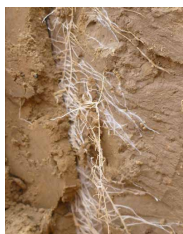
Racines en «arête de poisson» dans les fissures
